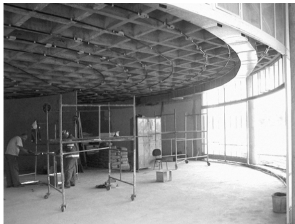
Figura 2b – Casa do Baile, salão com estrutura em grelha e forro originalmente plano. Oscar Niemeyer, Arquitetura. Albino Froufe, Cálculo Estrutural.
